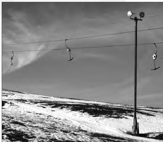
Die alte Pistenbeleuchtung muss aus Sicherheitsgründen abgerissen werden. Die Genossenschaft ist gegen einen kostspieligen Ersatz.
